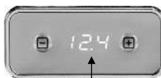
Temperaturanzeige Dampfkessel (t2, hier 124°C) - Punkt an zweiter Stelle
